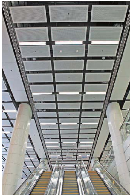
MTR Austin Station — False ceiling 港鐵柯士甸站 — 假天花
